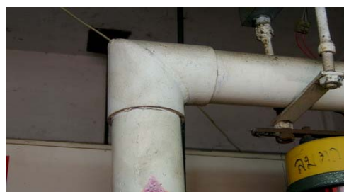
รูปที่ 2-3.19 การต่อท่อเมนหักฉาก 90^\circ ที่ไม่เหมาะสม
