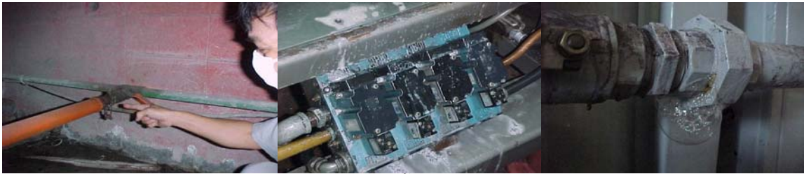
รูปที่ 2-3.25 การรื้อไหลที่ข้อต่อท่อเมน (มีน้ำมันซึมออกมา) และรื้อซิม (รอยทางมด)
