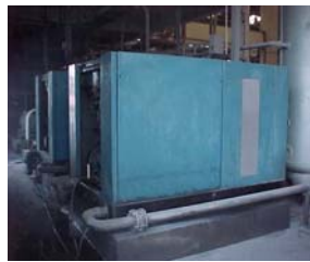
รูปที่ 2-3.21 การติดตั้งเครื่องอัดอากาศที่ไม่มีการทำความร้อนทิ้งออกห้อง
