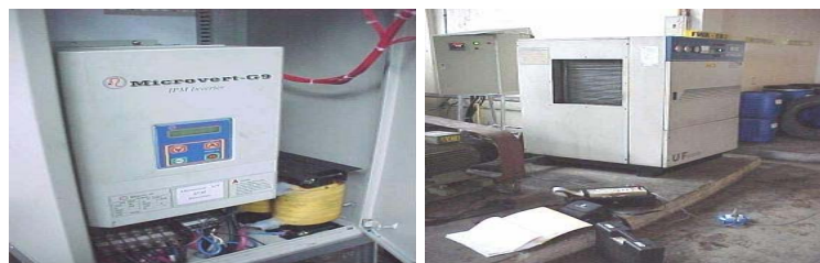
รูปที่ 2-3.43 การติดตั้งอุปกรณ์ควบคุมความเร็วรอบให้กับเครื่องอัดอากาศ
