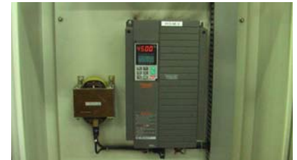
ภาพแสดงอินเวอร์เตอร์ที่ได้ทำการติดตั้งโดยทำ การปรับตั้งความถี่ที่ 45 Hz
