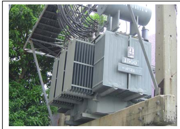
หม้อแปลงที่ทำการปรับลดแรงดันด้านทุติยภูมิ
