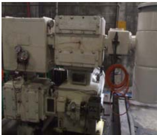
ภาพเครื่องอัดอากาศขนาด 75 Hp
