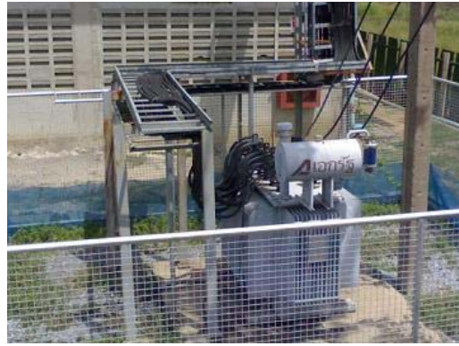
หม้อแปลง TR.5 แปลงไฟฟ้าจาก 22 kV. เป็น 400 V. จ่ายไฟฟ้าให้กับอาคาร 3, 4
