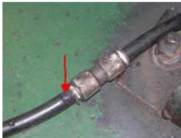
จุดที่มีการรั่วไหลก่อนการปรับปรุง
