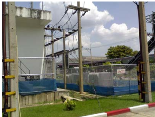
หม้อแปลง TR.1, TR.2, TR.6 แปลงไฟฟ้าจาก 22 kV. เป็น 400 V. จ่ายไฟฟ้าให้กับอาคาร 1, 5, 6, 7, 8, 9
