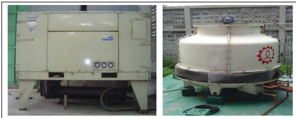
ภาพแสดงระบบทำน้ำเย็น และระบบคูลลิ่งทาวเวอร์
