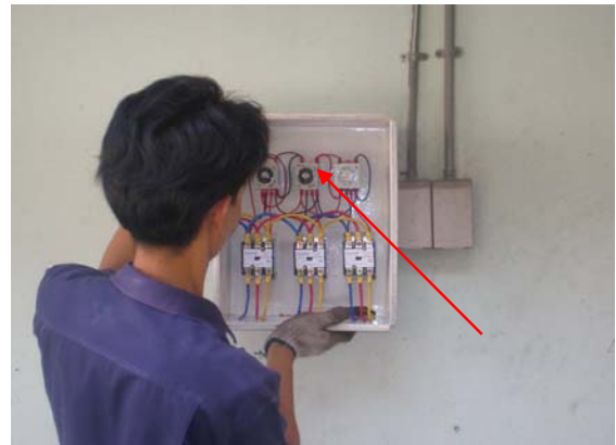
การติดตั้งสวิตช์เปิด - ปิด แสงสว่างอัตโนมัติ
