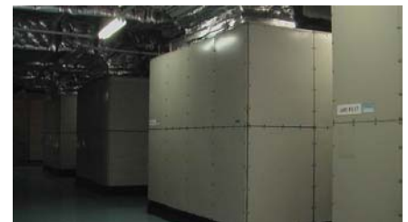
AHU ที่จะทำการติดตั้งอินเวอร์เตอร์เพื่อควบคุม ความเร็วรอบของพัดลม
