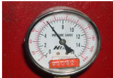
ภาพความดันลมอัด 6 บาร์เกจ (ก่อนการปรับปรุง)
