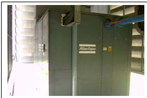
รูปแสดง Air-Compressor ก่อนปรับปรุง
