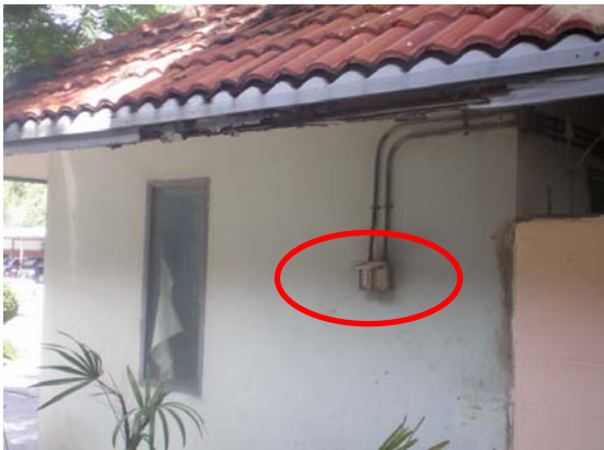
สวิตช์เปิด - ปิด แสงสว่างก่อนการปรับปรุง
