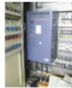
มอเตอร์โบลเวอร์ (ติดตั้งอินเวอร์เตอร์)
