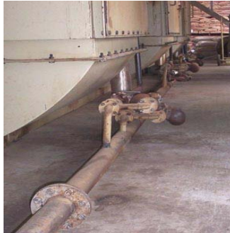
ท่อรวม Condensate
