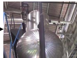
ถัง Deaerator ใช้น้ำ จากถัง Condensate
