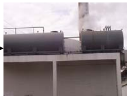
ถัง Condensate ร่วมกับน้ำหล่อเย็น
