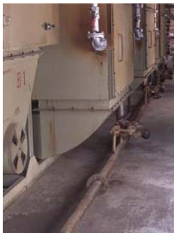
Condensate จาก ตู้ อบ (Dryer)
